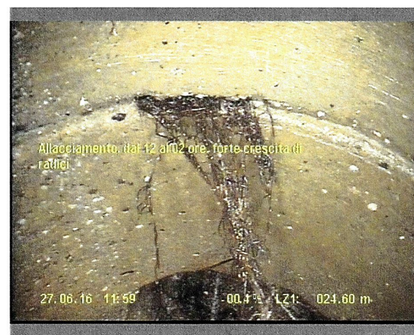
Figura 6 – Pz. 43-44: Giunto con penetrazione di radici
