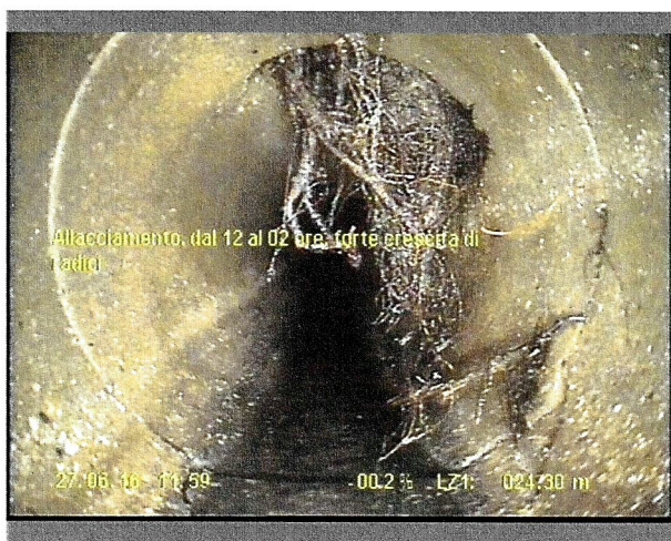
Figura 5 – Pz. 43-44: Presenza di radici
